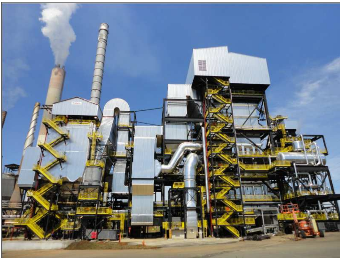
Figura 1 - Caldeira de Biomassa (vista frontal)
